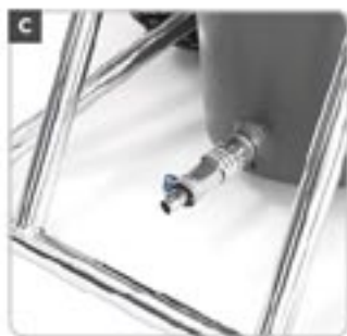
Wasserschlauchanschluss am Aggregat.
